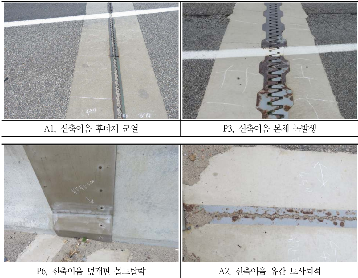
<그림 3.2.11> 신축이음장치 주요결합 및 손상현황
