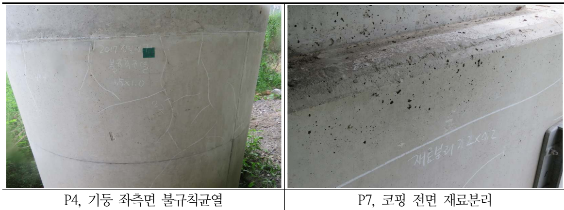
〈그림 3.2.5〉 교각 주요결함 및 손상현황
