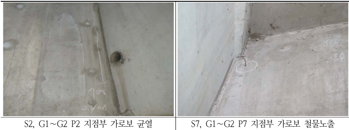
〈그림 3.2.3〉 거더 및 가로보 주요결함 및 손상현황
