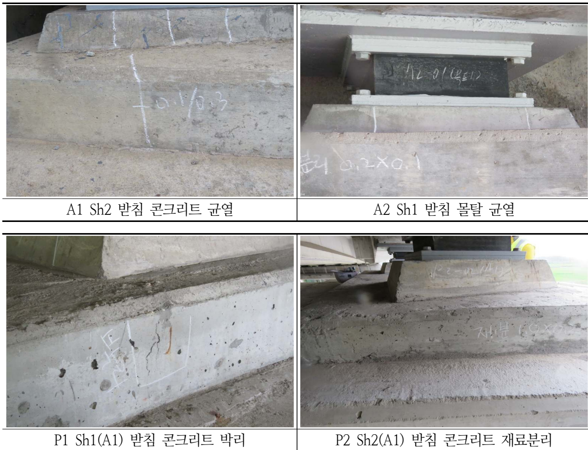
〈그림 3.2.7〉 받침장치 주요결합 및 손상현황
