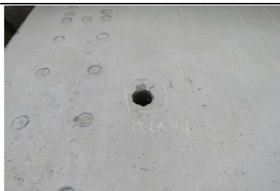
S4, G2 P3 지점부 우측면 인상홀 파손
