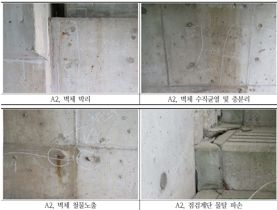
〈그림 3.2.4〉 교대 주요결함 및 손상현황
