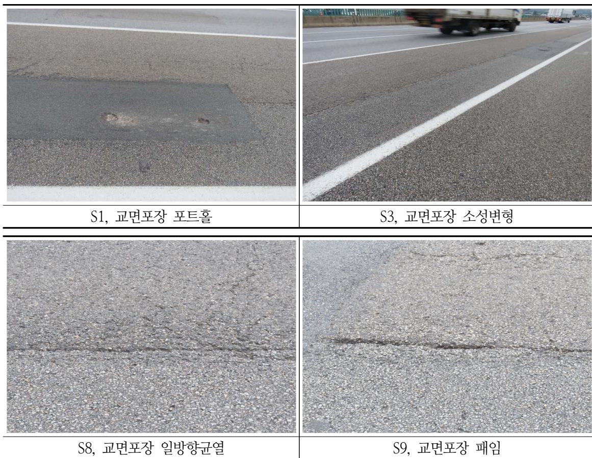
〈그림 3.2.12〉 교면포장 주요결함 및 손상현황
