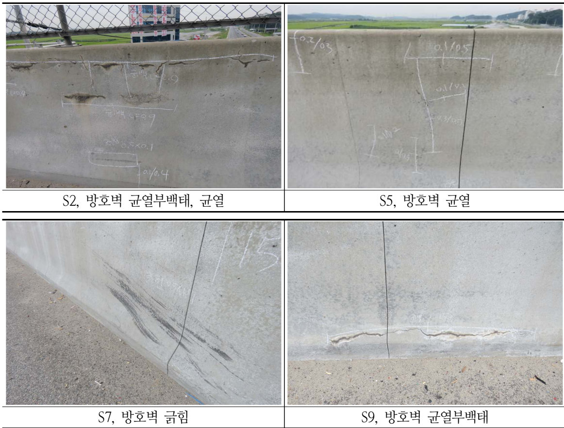
〈그림 3.2.13〉 방호벽 주요결함 및 손상현황
